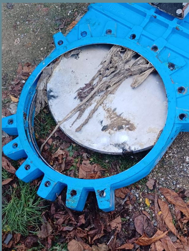
Accumulation de lingettes empêchant la fermeture complète et efficace d'une vanne guillotine, ouvrage indispensable pour isoler le réseau.
