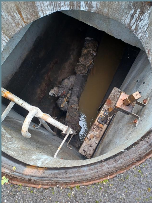
Dans cet ouvrage de prévention des inondations, les lingettes entravent le déversement et compromettent ainsi la protection du réseau.
