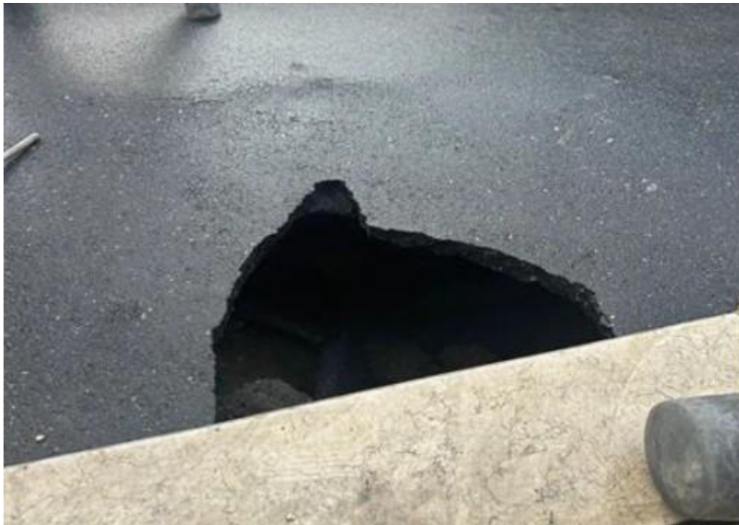
Figure 33 : Affaissement au 10 rue du Moulin
